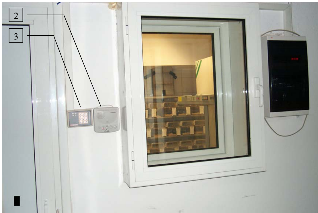
Φ2: Παράθυρο παρατήρησης του animal facility. Διακρίνονται η πόρτα εισόδου που ενεργοποιείται ηλεκτρομαγνητικά από το πληκτρολόγιο key pad [3] και η ενδοεπικοινωνία [2] του δωματίου.
