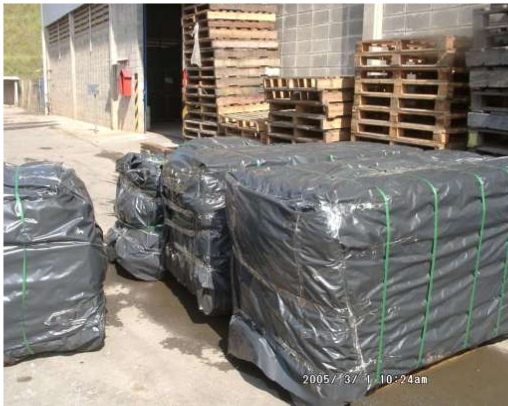
Foto 1 – Resíduos com amianto embalados em filme plástico resistente sobre pallets e cintados.
