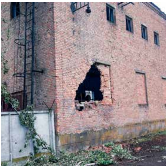
Насосна станція I підйому Південно-Донбаського водопроводу
