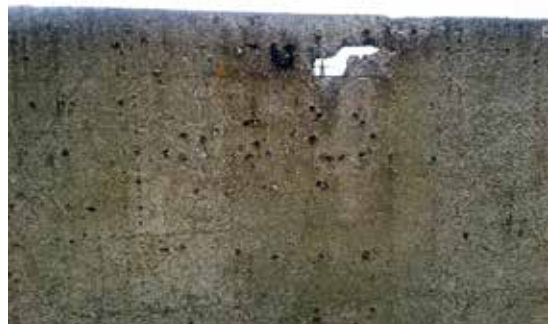
Наслідки обстрілу огорожі
