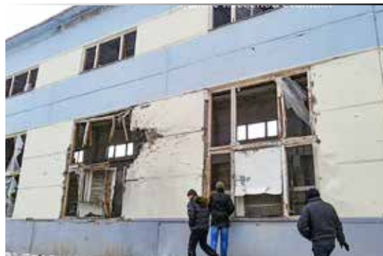
Будівля насосної станції після обстрілу
