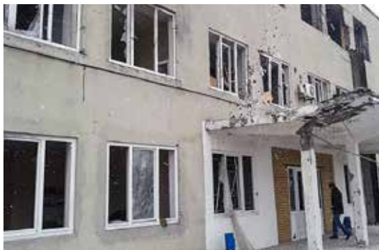
Пошкоджена будівля адміністративно-побутового корпусу
