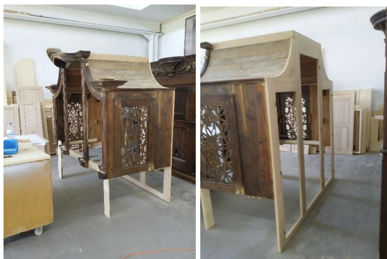
Figura 2 – Construção de uma estrutura de consolidação e vedação da parte superior posterior da caixa do órgão.
