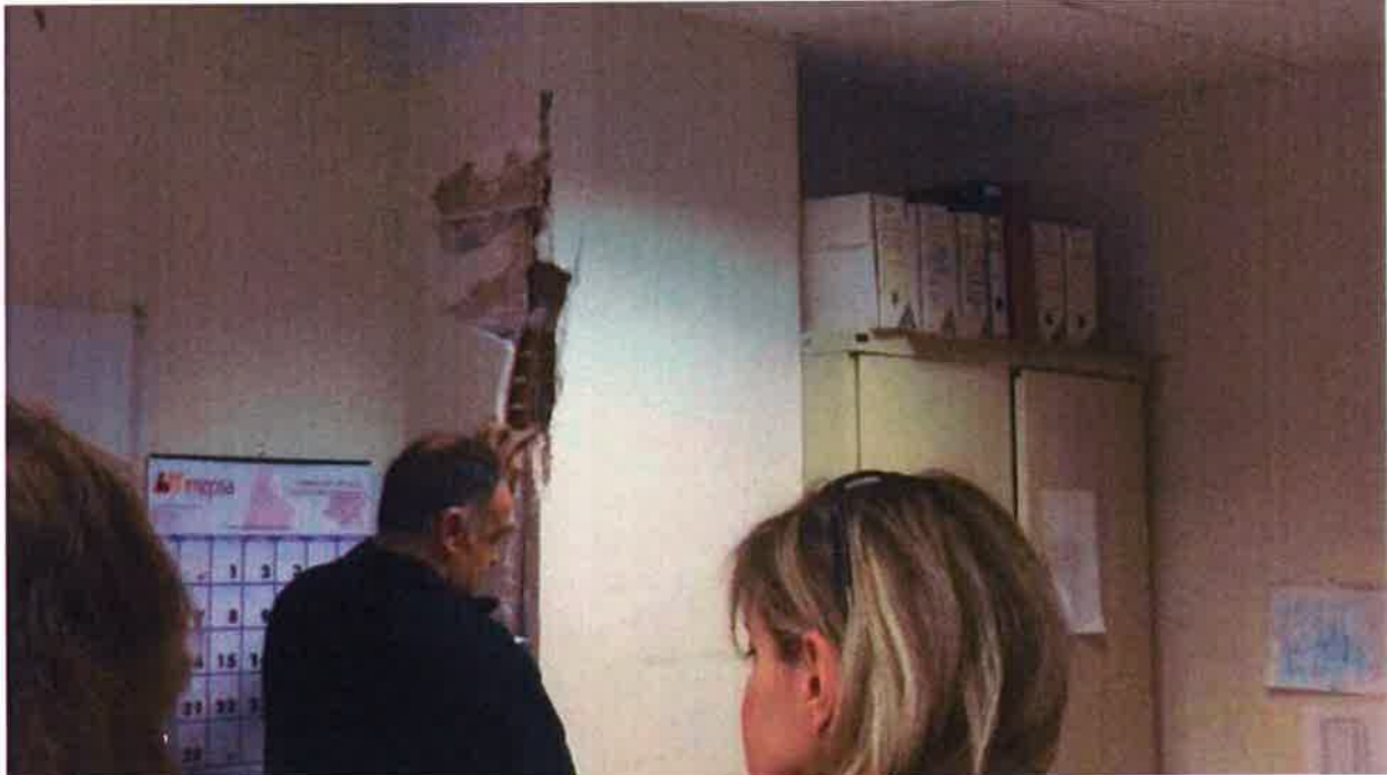
Infraestructuras en mal estado en los juzgados de Leganes (Madrid)
