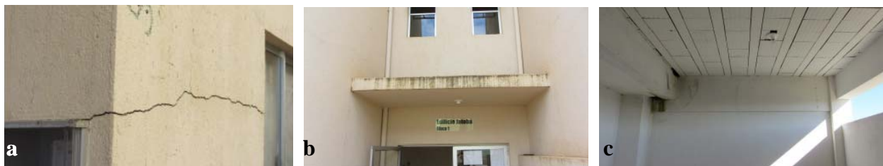
Figura 6 – Aspectos construtivos dos edifícios do Conjunto Residencial Floresta: a) fissuras na região das vergas; b) laje plana sobre a entrada principal do edifício; c) falta de esquadria nas aberturas do salão de uso coletivo.
