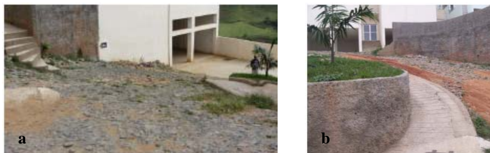
Figura 7 – a) Acesso muito inclinado; b) Falhas no calçamento.
