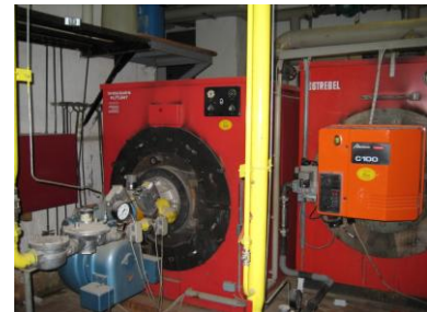
Die alten Gaskessel haben ausgedient!
