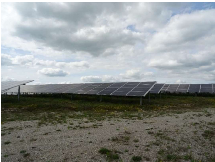
Centrale photovoltaïque de Soucia Source : EVEN Conseil
