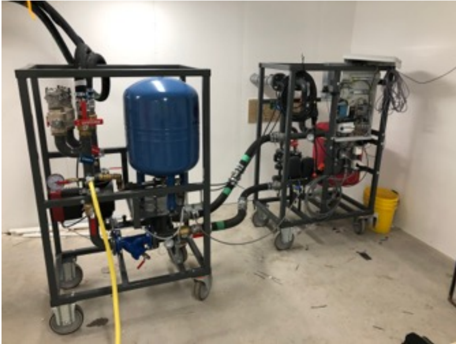
Bild: Tillfällig Fjärrvärmecentral. Samtliga funktioner övervakas och kan styras på distans. Larm för kritiska värden som till exempel läckage eller tryckfall. Logg av energi och effekt
