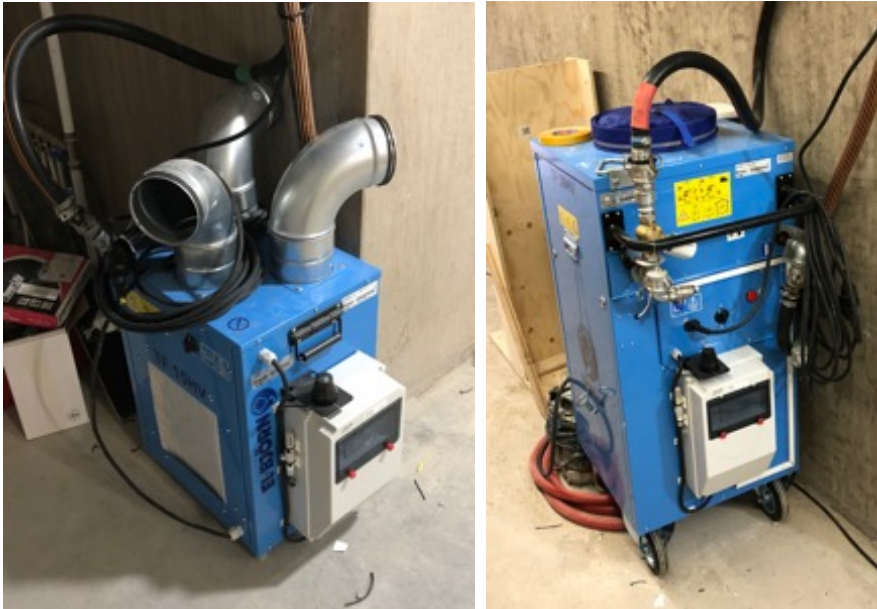
Bild: Värmemaskiner för hetvatten, 15 och 30 kW. Varje värmemaskin är uppkopplad med möjlighet att styra på distans.
