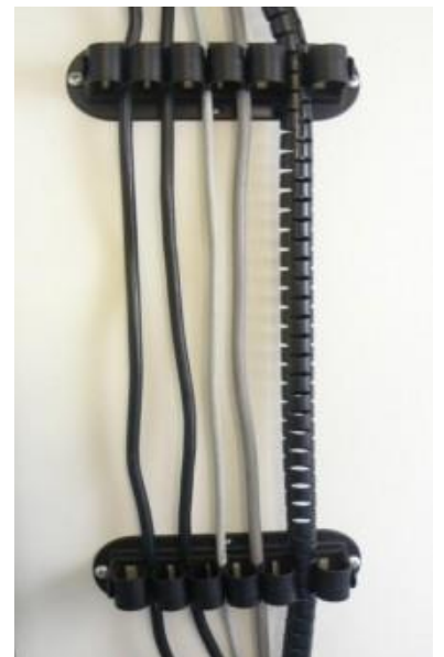
Johtopidike asennettuna seinälle
