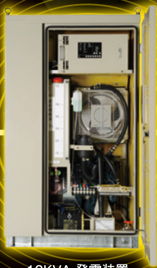
10KVA 発電装置
