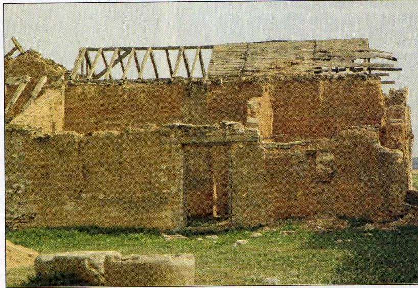
◀ Casa de campo con muros de adobe, muy deteriorada a los pocos años de haber sufrido el expolio de las tejas del tejado. En la página anterior, estructura metálica que ha servido de base para habilitar una rampa por la que deslizar las tejas extraídas de esta edificación rural (fotos: P.J. Cordero).
