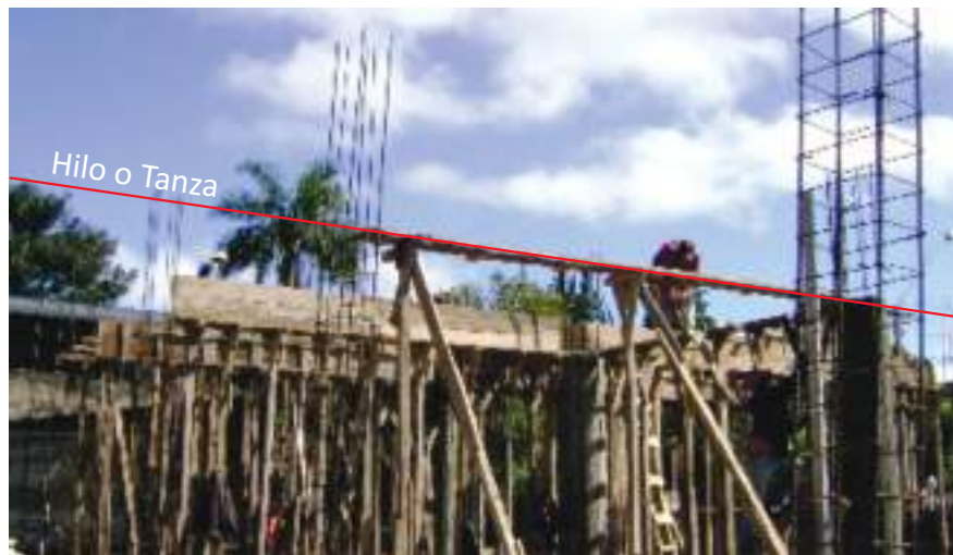
Foto: Nivelación del fondo de viga, aquí se apoya en un pilar y en puntales con cabezales
