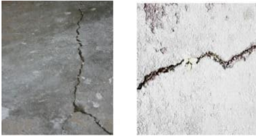
Рис.9: Бетонный строительный трещины из-за плохой строительной практики; вода добавляется в свежий бетон
