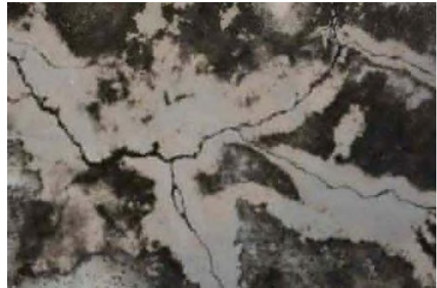
Рис.8: Бетонная трещина из-за движения влаги
