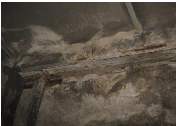
Рис.5: Растрескивание из-за коррозии арматуры
