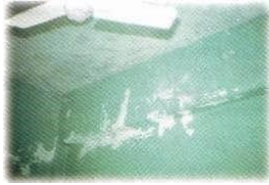
Рис.11: Утечка из кровельной плиты
