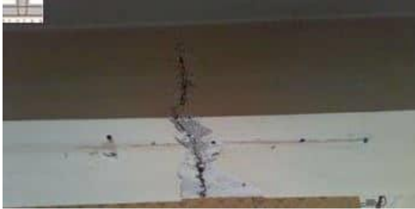
Рис.10: Основная структурная трещина в балке из-за плохой практики детализации
