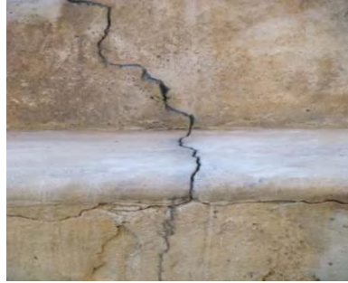
Рис.4: Бетонные строительные трещины из-за движения ползучести
