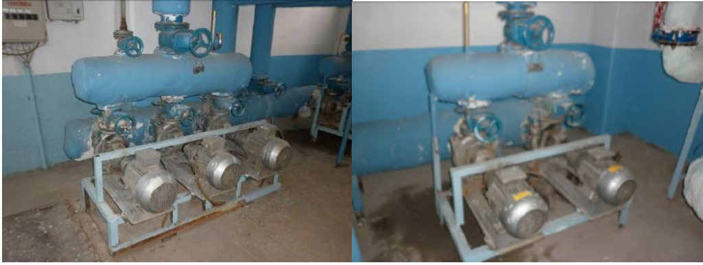
Resim 5.1. 7,5 kw ve 4 kw devirdaim motorları
