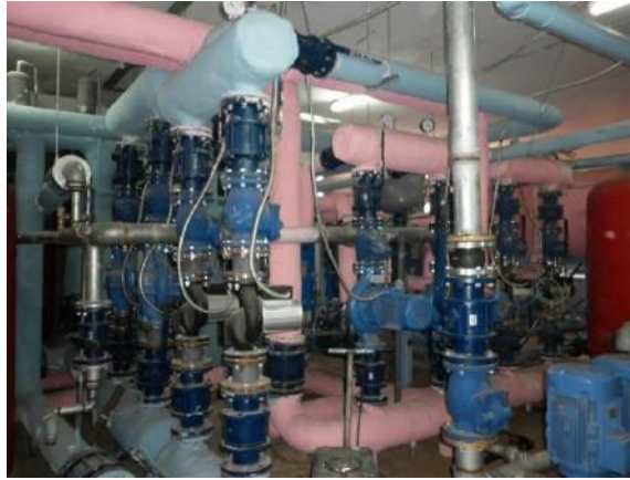
Resim 5.2. Sıcak Su Pompaları
