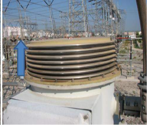
C Faz Akım Trafosu Körük Uzunluğu: 15.5 cm
