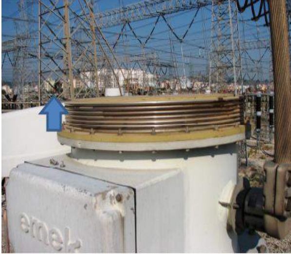
B Faz Akım Trafosu Körük uzunluğu: 6.5 cm
