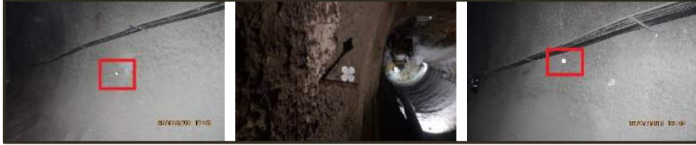
Şekil 3. 3 Tünel içinde kullanılan deformasyon noktaları (Denizli Honaz Tüneli)
