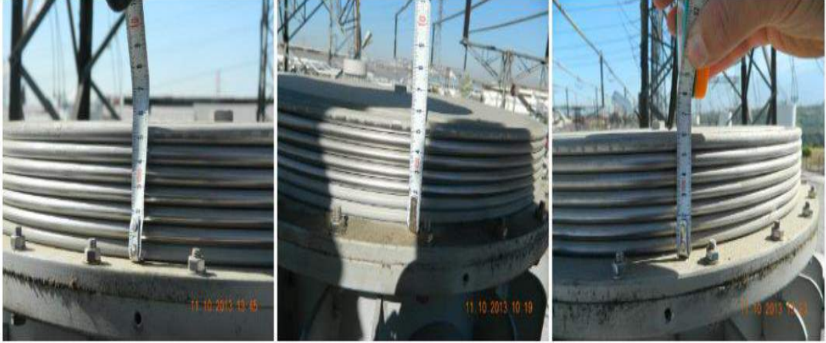
Şekil 2. 420 KV Çayırhan fiderine ait A-B-C faz üst ünite körük kontrolü
