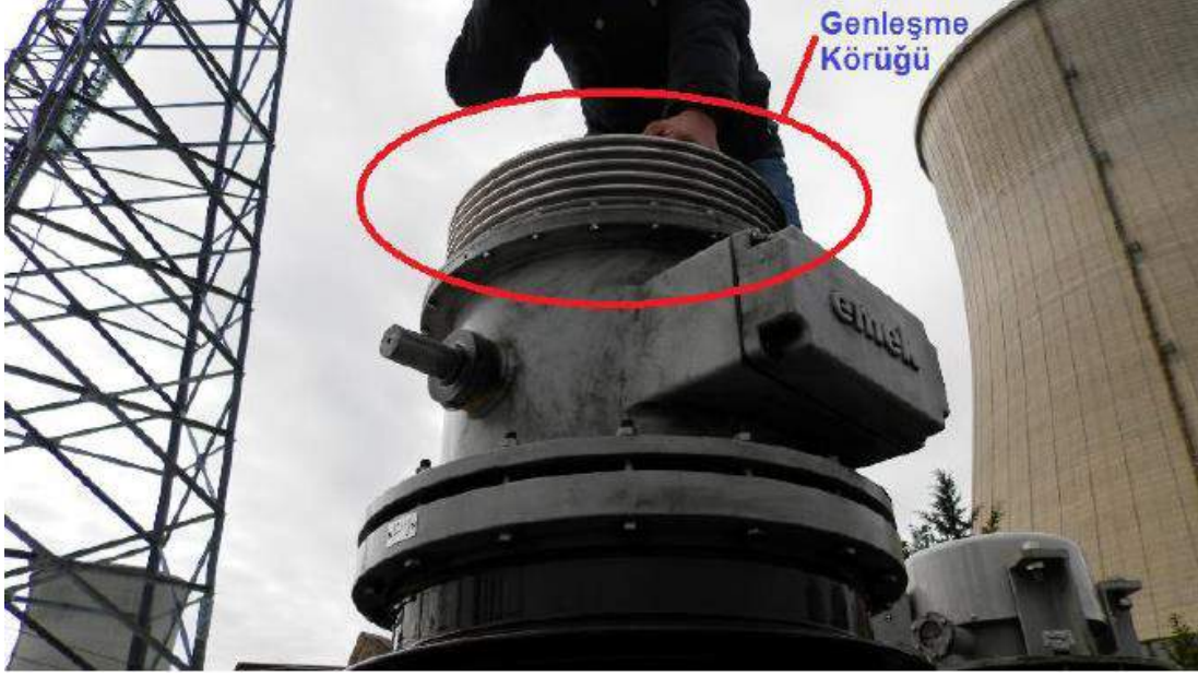
Şekil 1. Kaskat bağlı akım transformatörlerine ait genleşme körüğü
