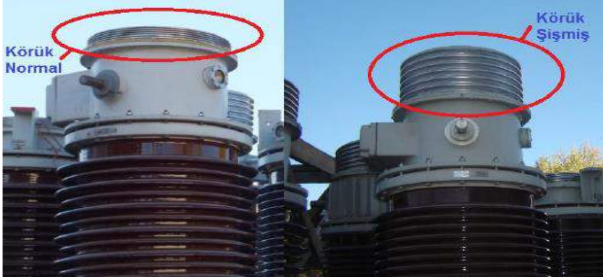
Şekil 4. Fiziki kontrol sonrası tespit edilen şişmiş genleşme körüğü
