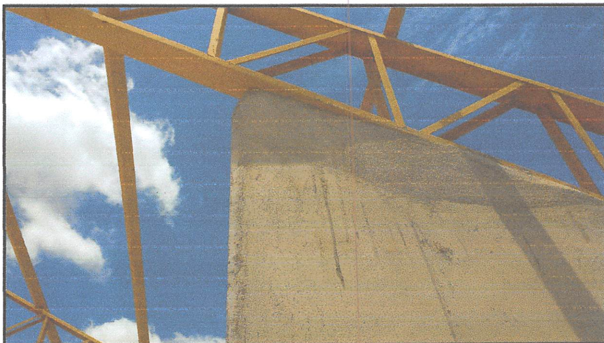
Complemento no pilar executado após sua concretagem e mesmo assim a estrutura metálica ainda ficou assente fora do mesmo.
