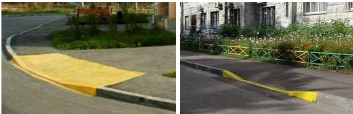
Рисунок 4 - Бортовой камень в местах пересечения тротуаров с проезжей частью
