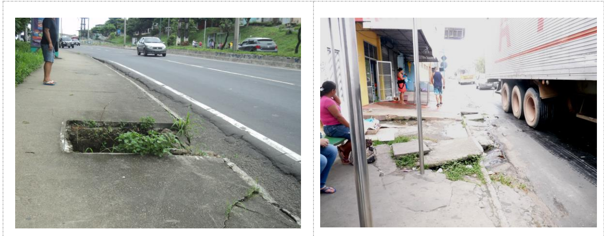
Figura 23– Fotografia ilustrando o estado de conservação das calçadas no trecho analisado
