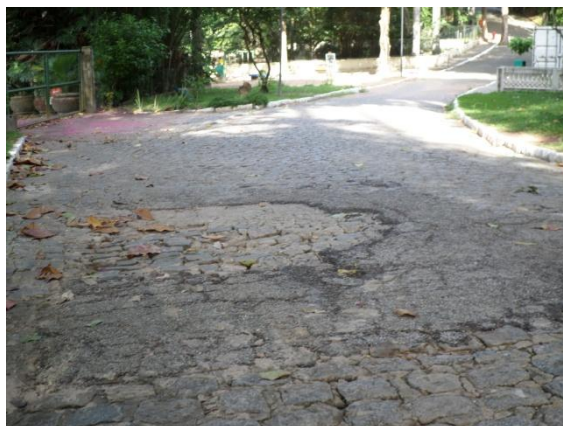
Figura 59: Foto do piso com potencial risco ao usuário distraído.
