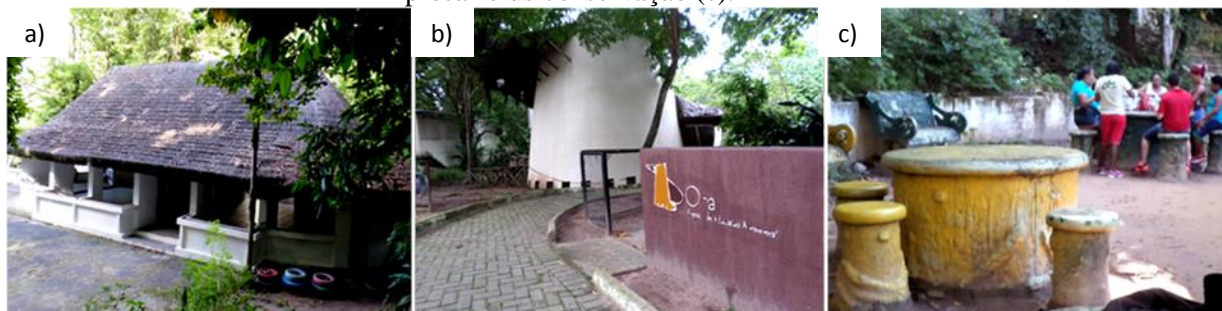
Figura 48: Fotos de equipamentos do Parque Zoobotânico Arruda Câmara fora de funcionamento (respectivamente, a: Espaço Jequitibá, b: OCA) e área de piquenique em estado precário de conservação (c).
