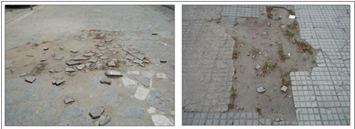
Figura 20. Exemplos de pisos com com péssimas condições físicas.
