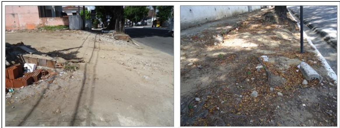
Figura 18. Exemplos de calçadas não pavimentadas.
