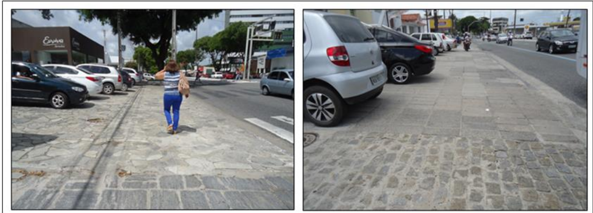
Figura 21. Exemplos de calçadas rebaixadas em vários pontos, possibilitando o conflito entre pedestres e veículos.
