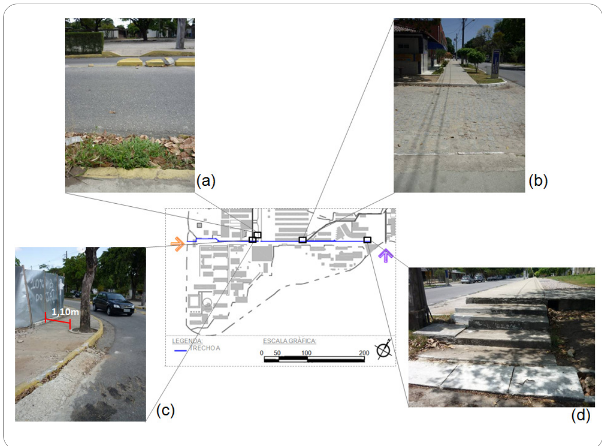
Figura 29: Quadro de imagens do Trecho A – a) menor faixa livre de circulação do trecho; b) entrada de estacionamento sem sinalização e rebaixamento da calçada; c) travessia de via sem sinalização e sem rebaixamento em um dos lados da calçada; d) escada do trecho.
