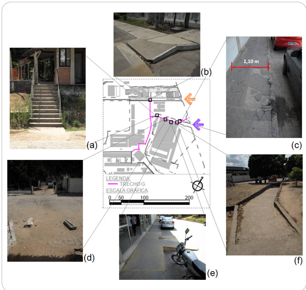
Figura 41: Quadro de imagens do Trecho G – a) escada de acesso ao CCS; b) rebaixamento em desacordo com a NBR 9050 (ABNT, 2004); c) menor faixa livre de circulação do trecho; d) travessia sem sinalização; e) rampa de acesso ao HU com inclinação superior a 8,33%; f) rampa sem patamar na mudança de direção.
