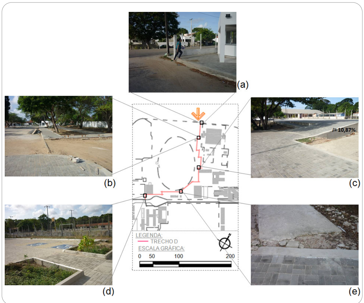
Figura 35: Quadro de imagens do Trecho D – a) ausência de rebaixamento da calçada para o acesso de pedestres; b) ausência de rebaixamento da calçada ou implantação de faixa de travessia elevada na entrada de veículos; c) rampa com inclinação de 10,87%; d) vagas para pessoa com deficiência; e) quebras no revestimento do trecho.
