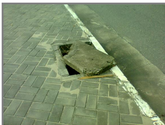
Figura 59. Foto mostrando as tampas com desníveis
