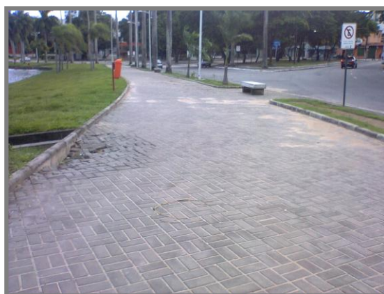
Figura 58. Foto indicando desníveis na faixa de circulação
