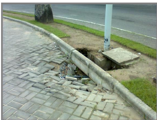
Figura 57. Foto dos buracos na faixa de circulação
