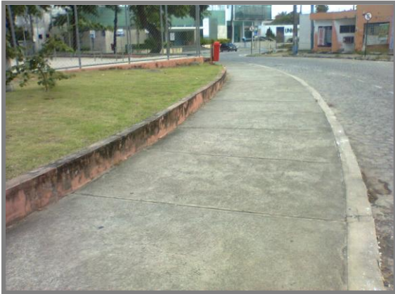
Figura 35. Fotografia mostrando o piso sem sinalização tátil de alerta direcional
