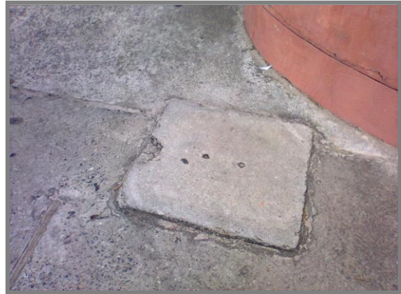
Figura 36. Tampas de concessionária sem textura e desnivelada
