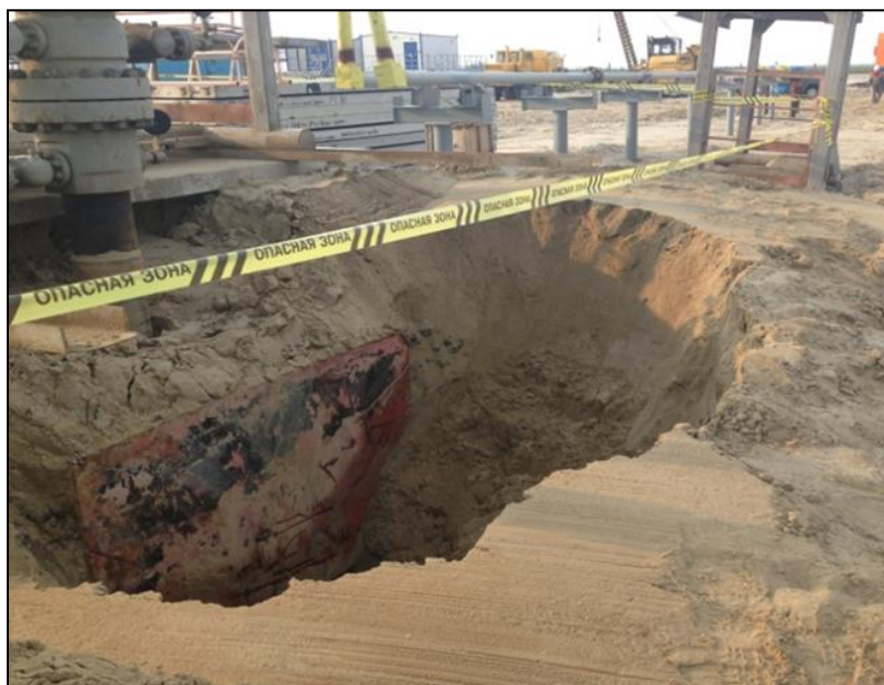
Рис. 3. Приустьевые провалы вокруг эксплуатационных скважин возникшие вследствие оттаивания ММП.
