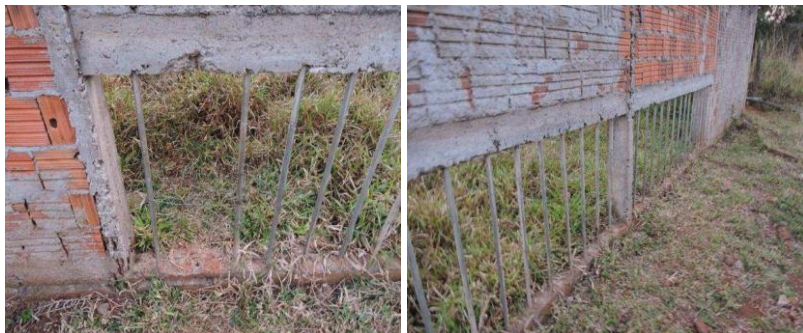
Fotos das Grades parte inferior muro – para escoamento de água pluvial
