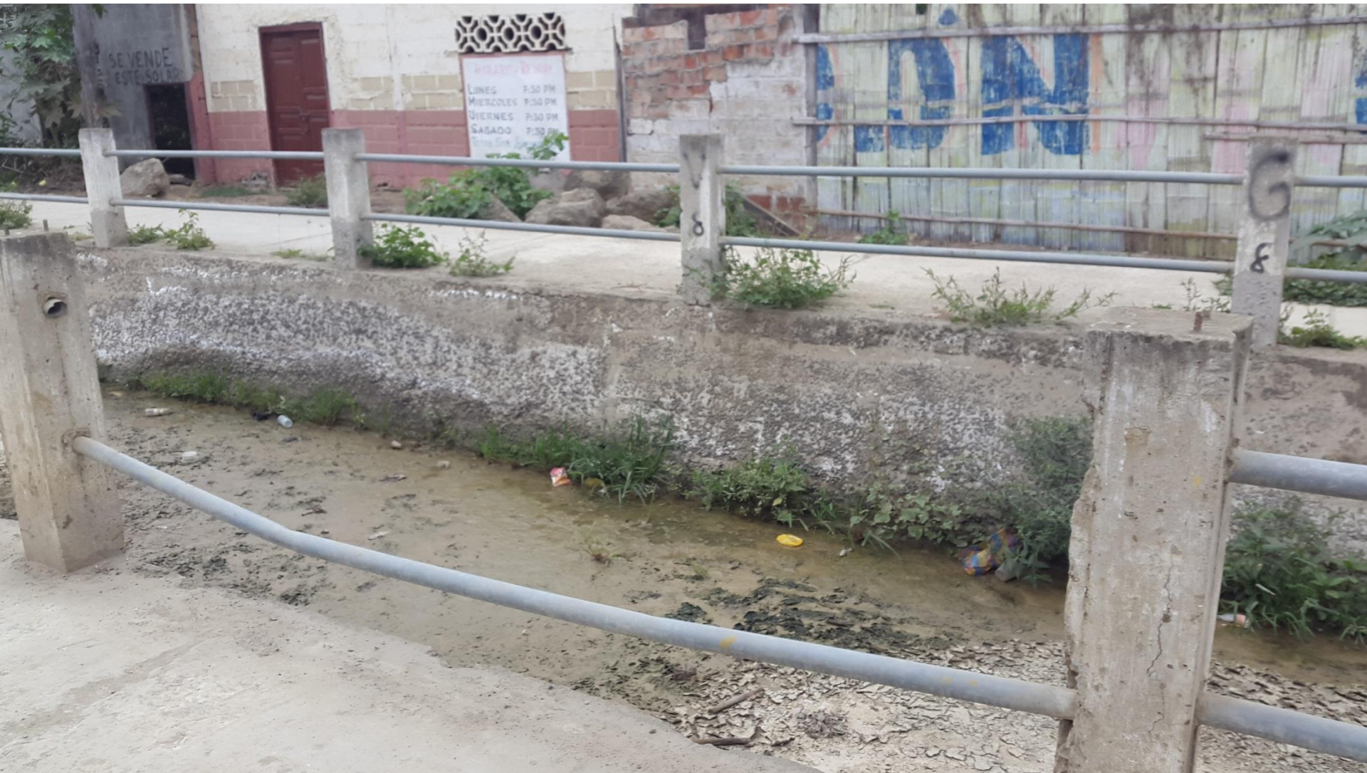
FOTO: “Zanjas pluviales con caminería deteriorada y contaminación por aguas negras en el Canal Natural”
