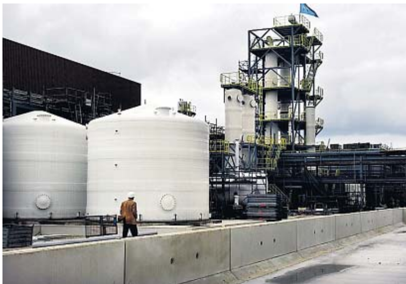
▲ Deel van de installatie van Akzo in Emmen. Foto DvhN
