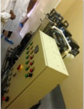
Système d'osmose inversée
